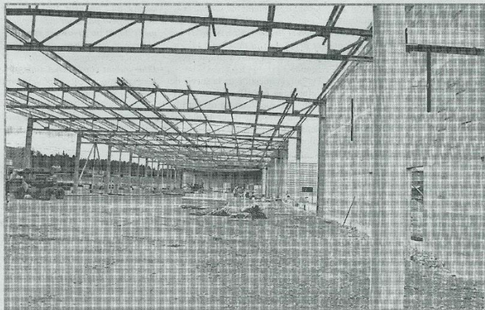
Le site de la future unité de production Gainotech, soit 35 salariés travaillant à sa construction pendant un an
